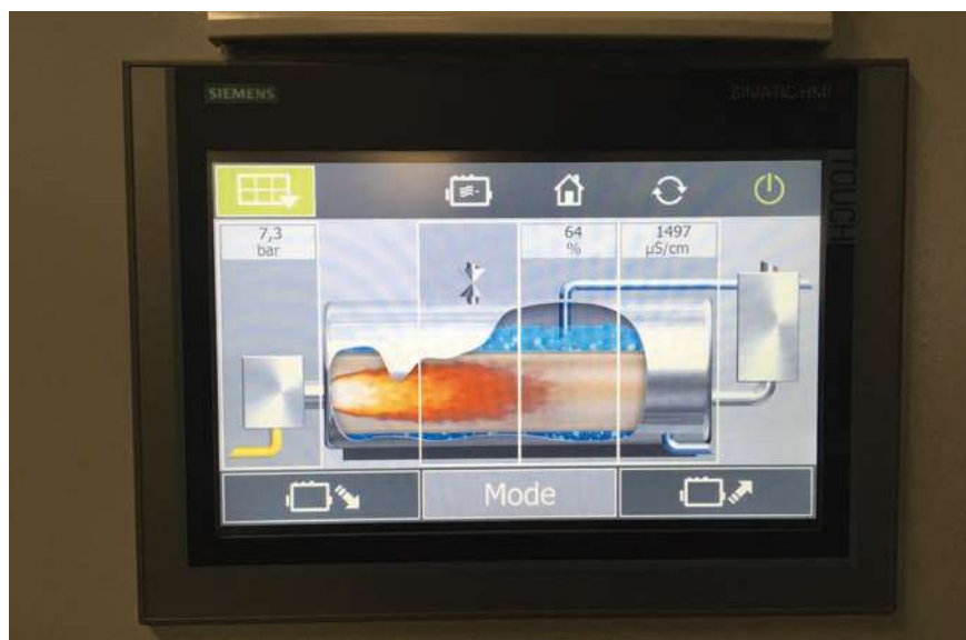
Kedlerne overvåges konstant. Her kan man fornemme flammen og det omkringliggende vand.
