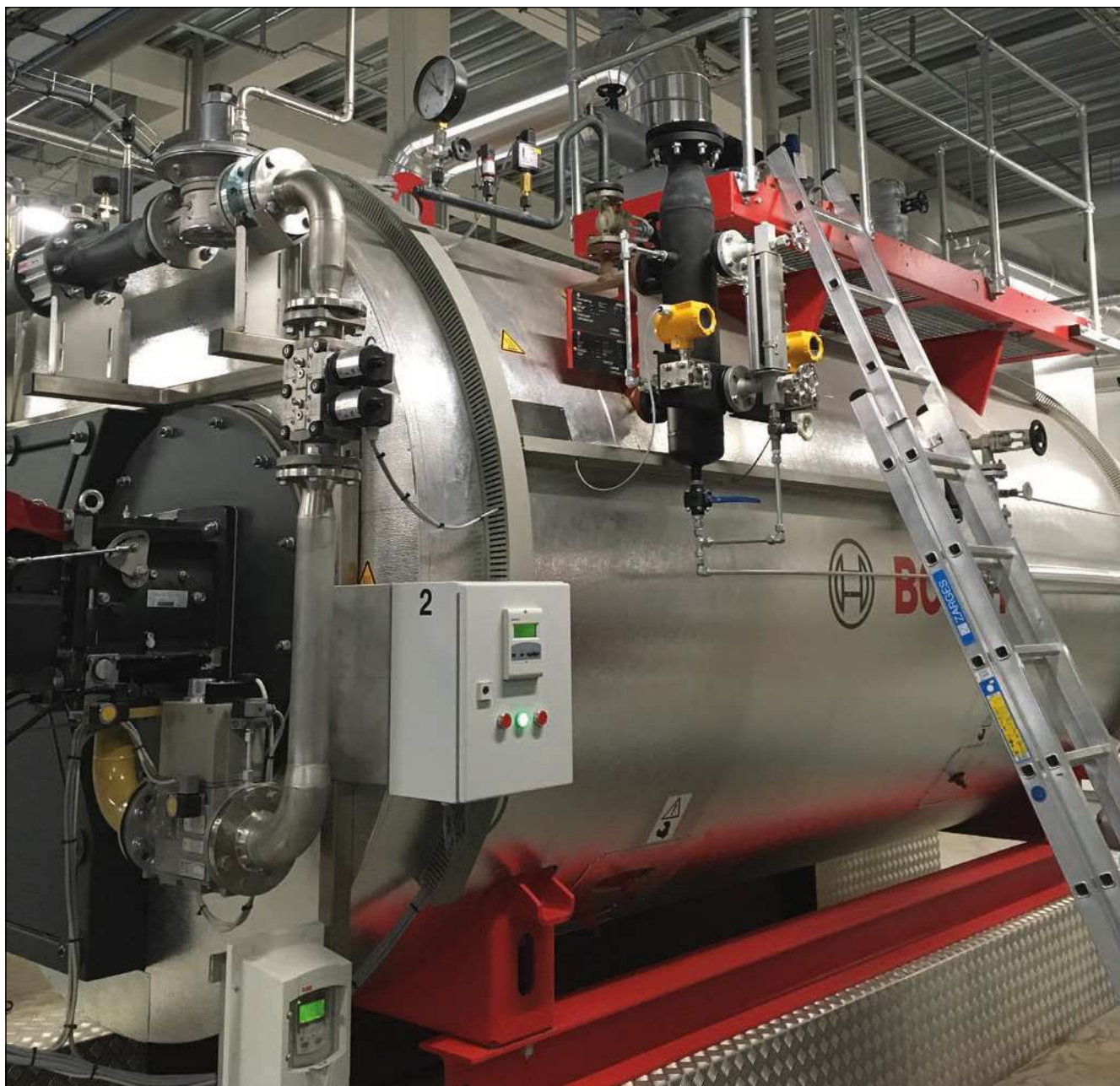
En af de tre imponerende dampkedler, der supplerer sterilcentralens autoklave med 3.800 kg damp i timen.
